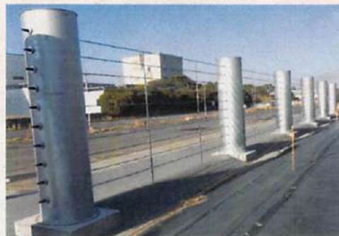
津波漂流物防護柵(引き波)の 設置状況(令和5年1月)
