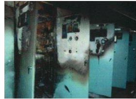
1号機高圧電源監視室 鉄筋建造物
