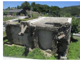
横倒しの鉄筋建造物
